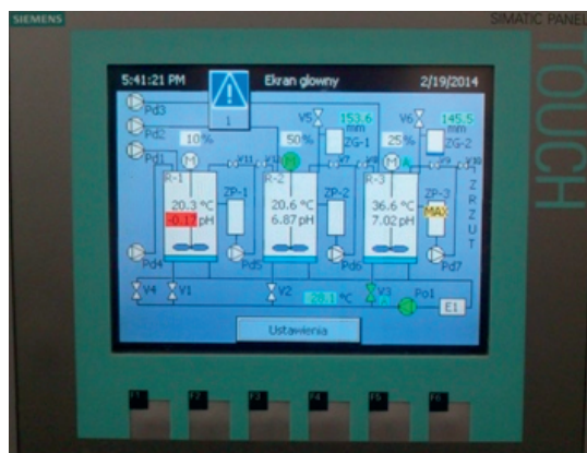
Rysunek 16. Widok panelu dotykowego do PLC
